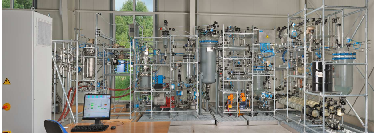
FAT der Pilotanlage im Zentralwerk Ilmenau
